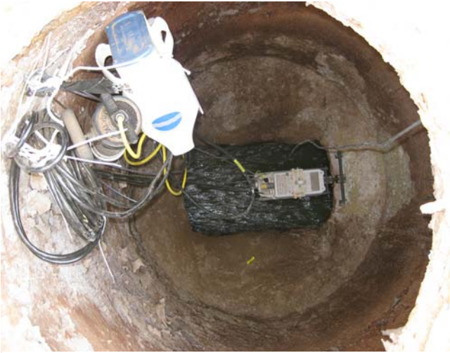
DDS Flo-Logger/Flo-Dar in 20' Deep Manhole
